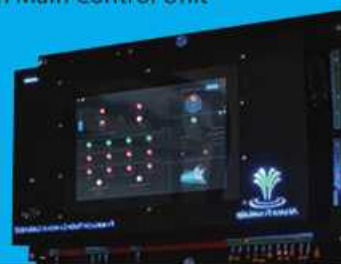
دستگاه کنترلر آبنما Fountain Main Control Unit
